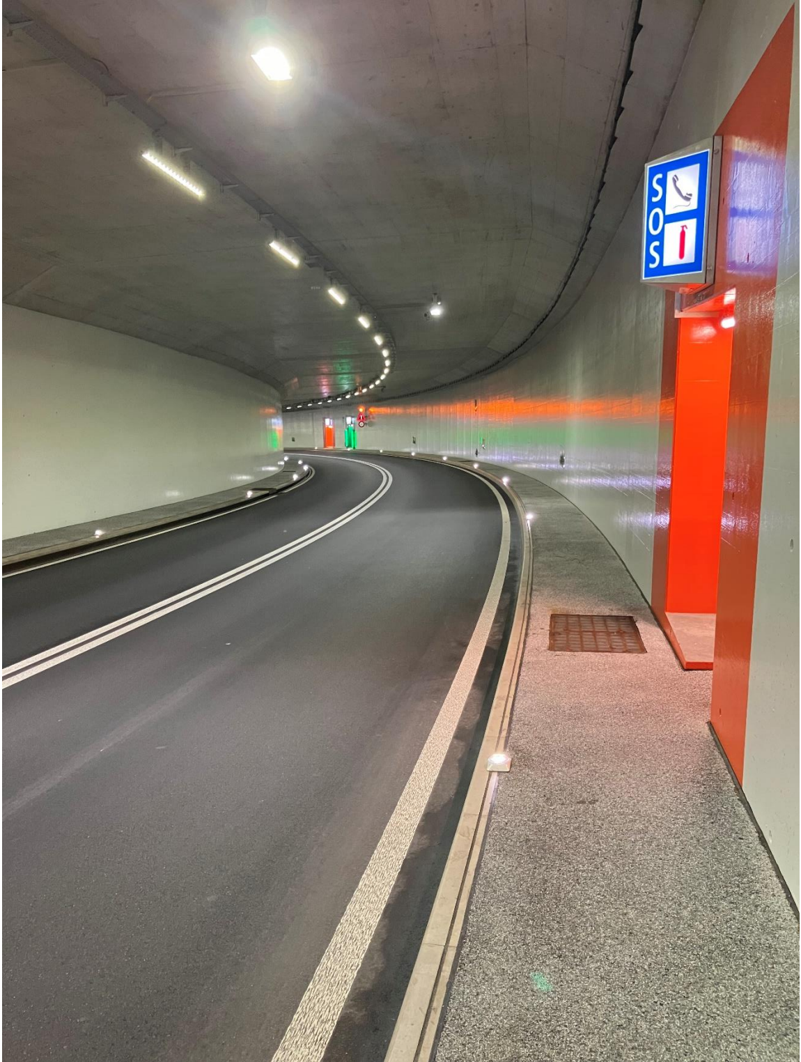
Im Tunnel Geissbüel in Baar, der zur Tangente Zug/Baar gehört, sind verschiedene technische Anlagen installiert. Diese werden jährlich geprüft.
