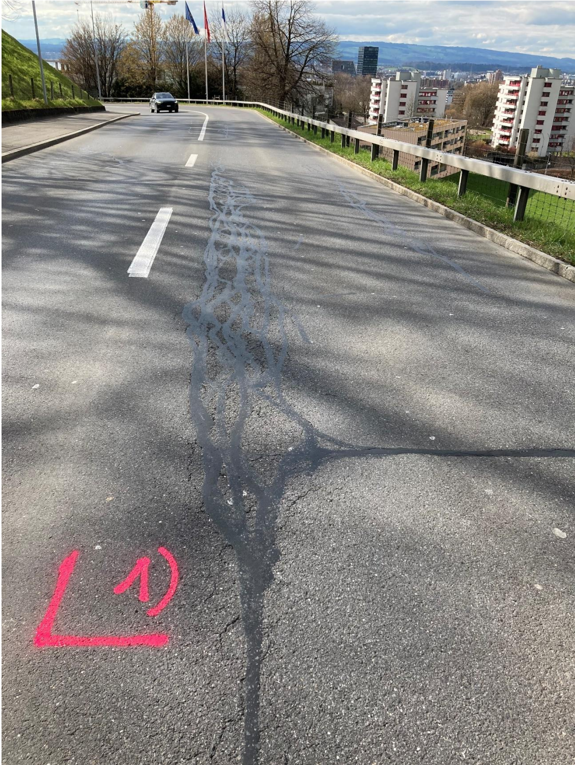
Die Ägeristrasse in Zug weist Belagsschäden auf, die in der kommenden Woche beseitigt werden.
