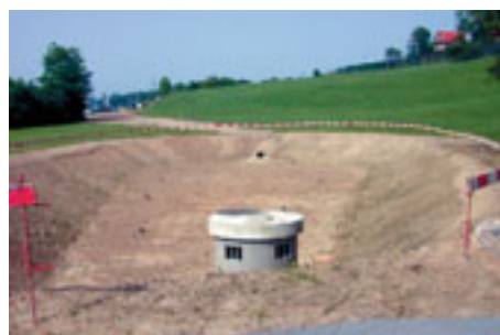
Abbildung 26: Retentionsfilter- becken Talacher. Strassenabwas- serbehandlungs- anlage in Bau (links und im Be- trieb (rechts))
