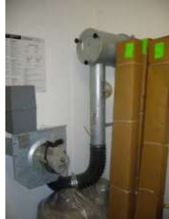
Schutzraumausrüstung beim Ventilationsaggregat
