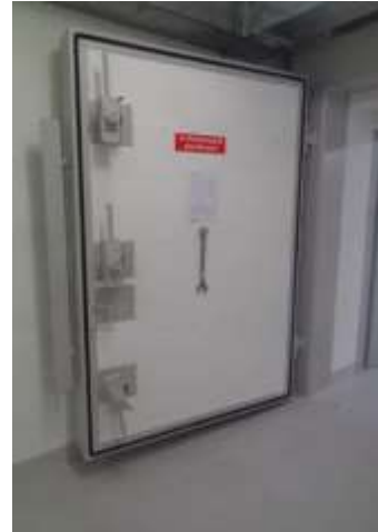
Nachträgliche Panzertüre (PT) mit demontierbarer Schwelle
