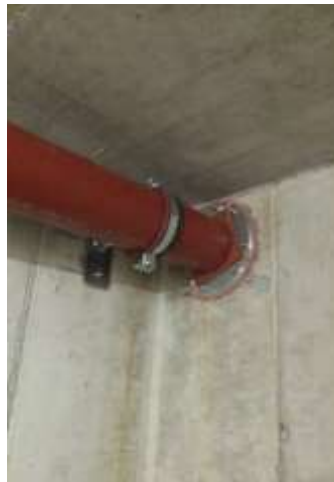
Wanddurchführung einer Wasserleitung (Abstellorgan ausserhalb)
