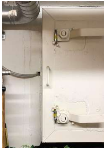
Entwässerung Luftentfeuchter in den Notausstieg/Fluchtröhre
