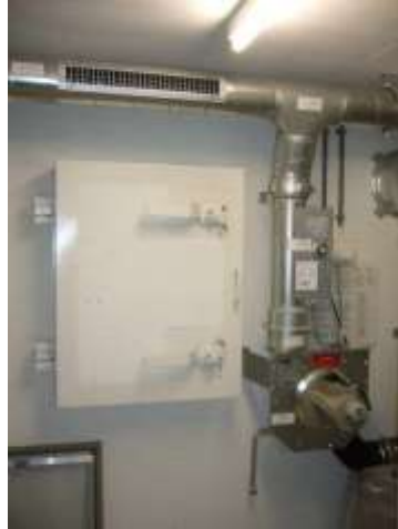
Ventilationsaggregat mit Querverteilleitung
