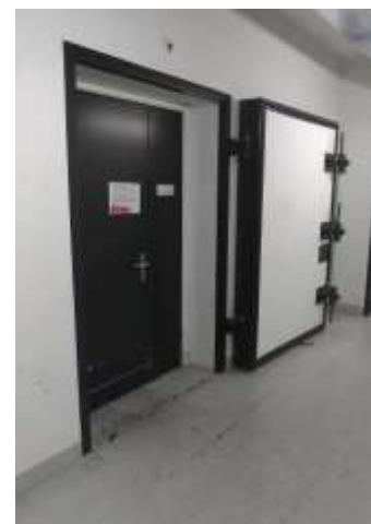
Grosse Panzertüre (PT3) mit demontierbarer Schwelle
