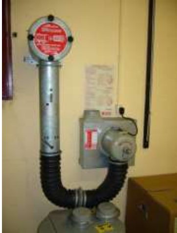
Ventilationsaggregat ohne Verteilleitung
