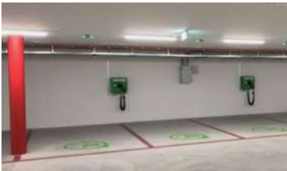
Tiefgarage mit Ladestationen für Elektrofahrzeuge
