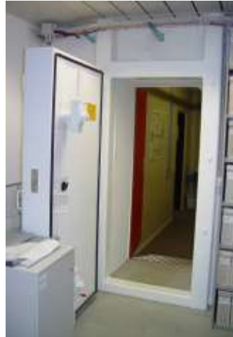
Nachträgliche Panzertüre (PT) mit fester Schwelle
