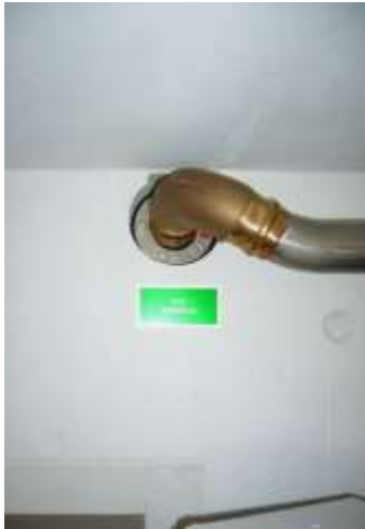
Wanddurchführung einer Wasserleitung
