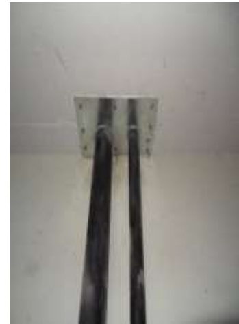
Deckendurchführung einer Abwasserleitung
